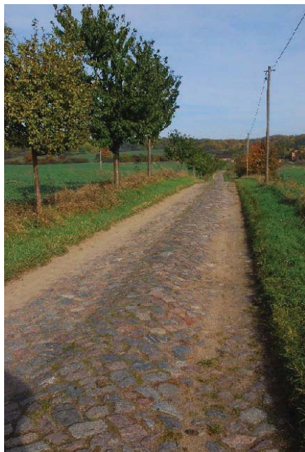
Die Pflasterstraße des Pilotvorhabens ist stark aufgewölbt, so dass ein Befahren mit PKW kaum möglich ist.
